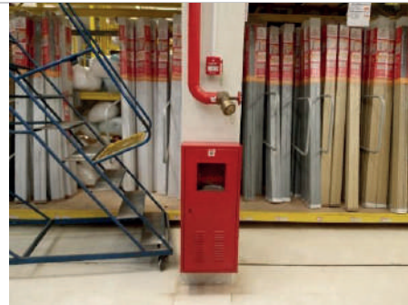
Pontos de hidrante do sistema contra incêndio Loja
