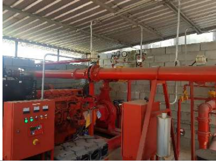
Sala de Bombas
