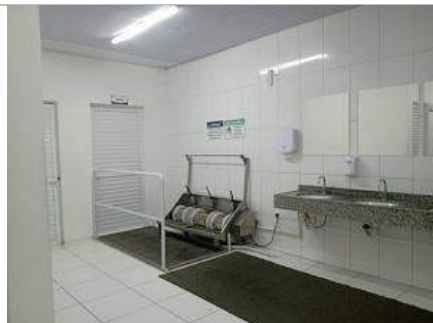
Sala de desinfecção
