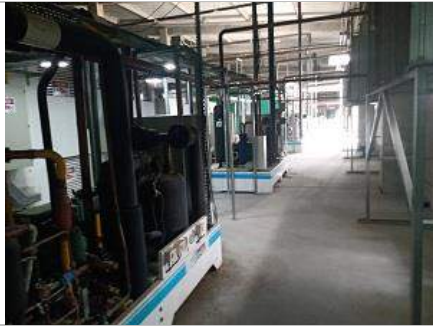
Sala de máquinas
