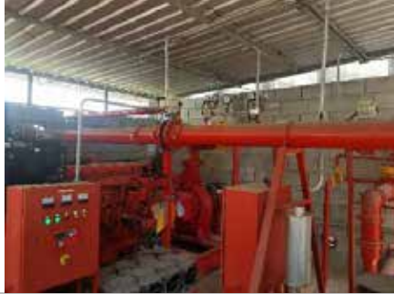
Sala de Bombas
