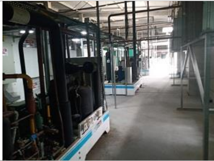
Sala de máquinas
